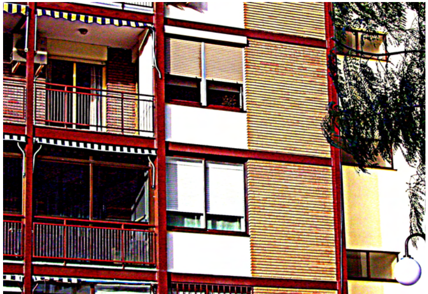
Viviendas de la calle Bachiller- Jaime Roig. Valls y G a Sanz. Foto del autor.
